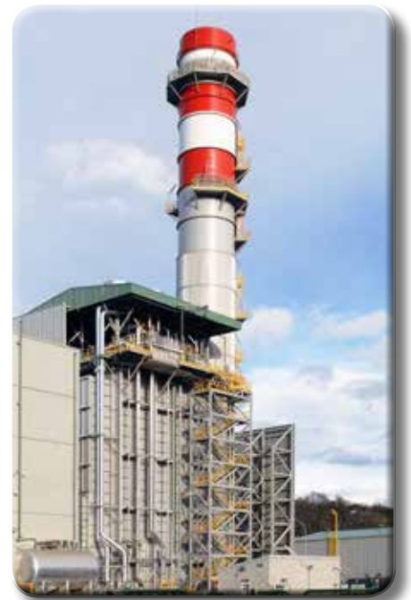
HRSG and stack, Soto 5 CCPP, Singapore (Copyright: Alstom)
