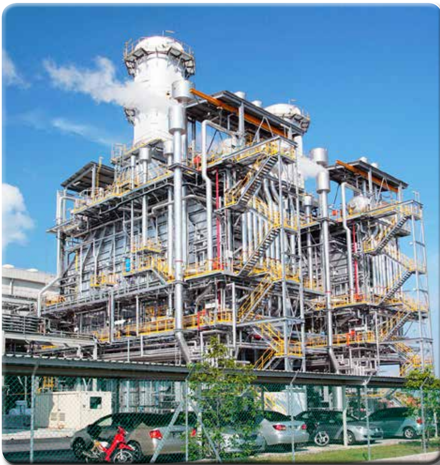
HRSG at the Keppel Cogen Power Plant, Singapore (Copyright: Alstom)
